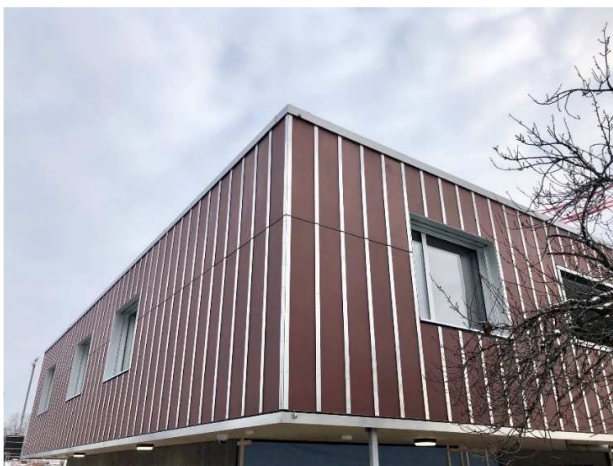
Solarfassade an der «Winter und Sports World Wallisellen» (liefert unter anderem Strom für das Eisfeld)
